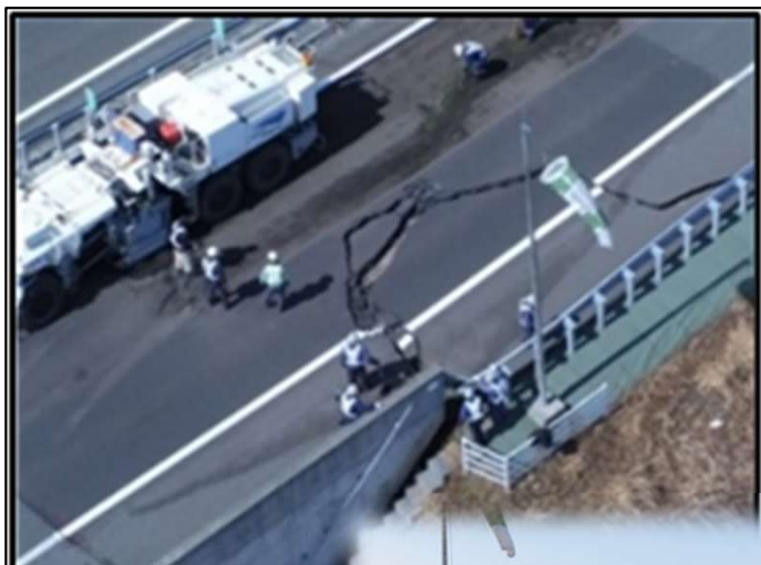
⑦常磐道 舗装損傷
